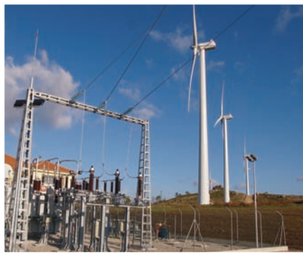
■ Aeroxeradores no Monte Corzán
